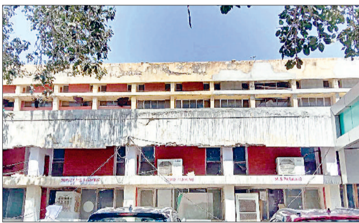
नारनौल। नवीनीकरण के दौरान अधूरा छोड़ा गया अस्पताल भवन व जर्जर अवस्था में खड़ा अस्पताल का पुराना भवन।
